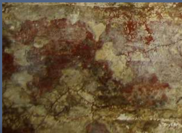
Izgled zida prije ugradnje arp-eossan sustava. Sadržaj vlage u zidu je > od 20%.
